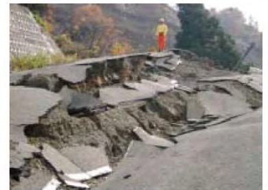
道路の崩壊（山古志村）
