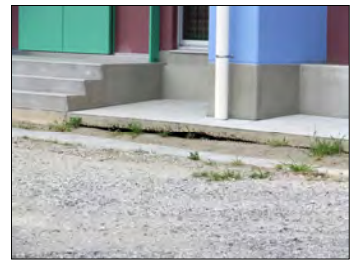
周囲の地盤沈下により基礎部分がむき出しとなった体育館
