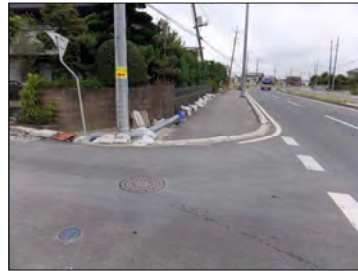
地盤の不同沈下により様々な方向に大きく傾いた電柱
