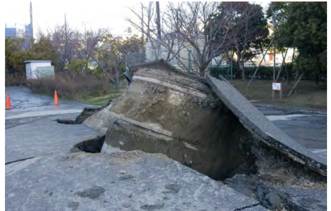
抜け上がり(東北地方太平洋沖地震)(出典: 浦安市)
