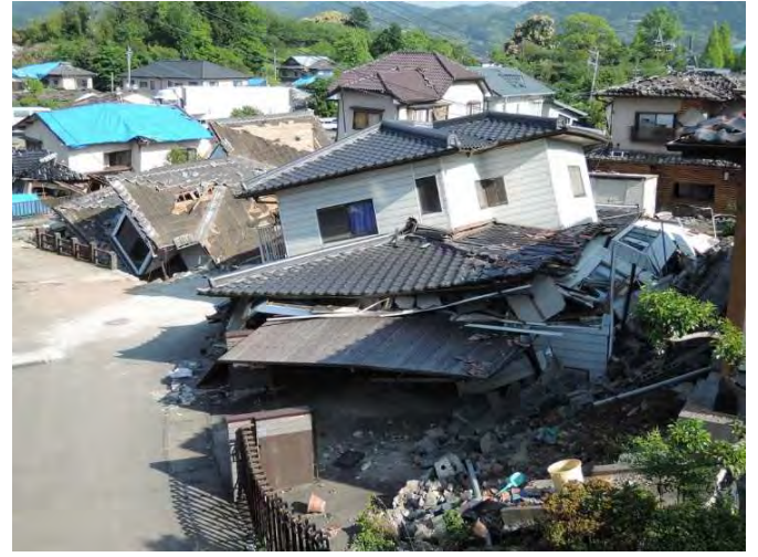
家屋の倒壊(熊本地震)
