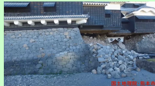
熊本地震による建物被害 (熊本城)
